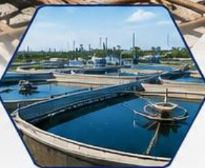
NHÀ MÁY XỬ LÝ NƯỚC THẢI
